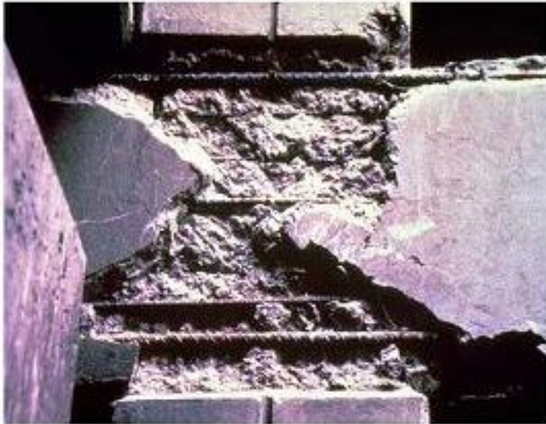
شکل ۸-۶-۲ کمانش میلگردهای طولی تیر در ناحیه اتصال
