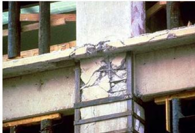
شکل ۷-۶-۲ کمانش میلگردهای طولی ستون در ناحیه اتصال
