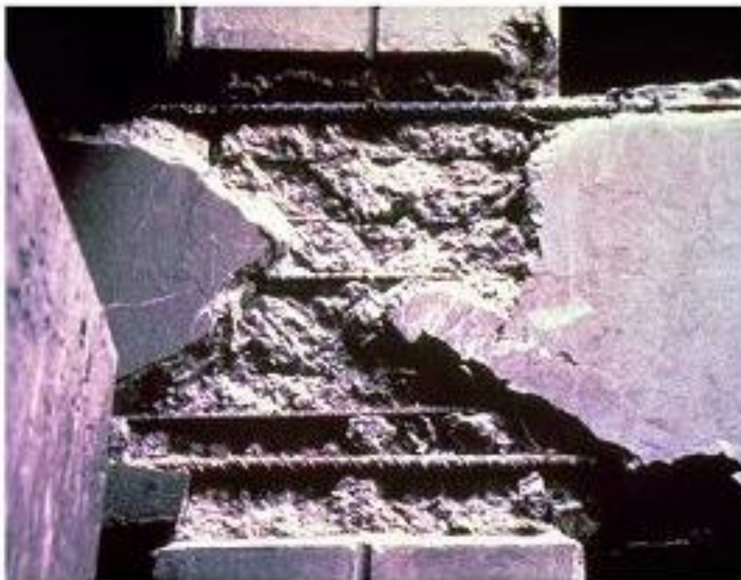
شکل ۸-۶-۲ کمانش میلگردهای طولی تیر در ناحیه اتصال
