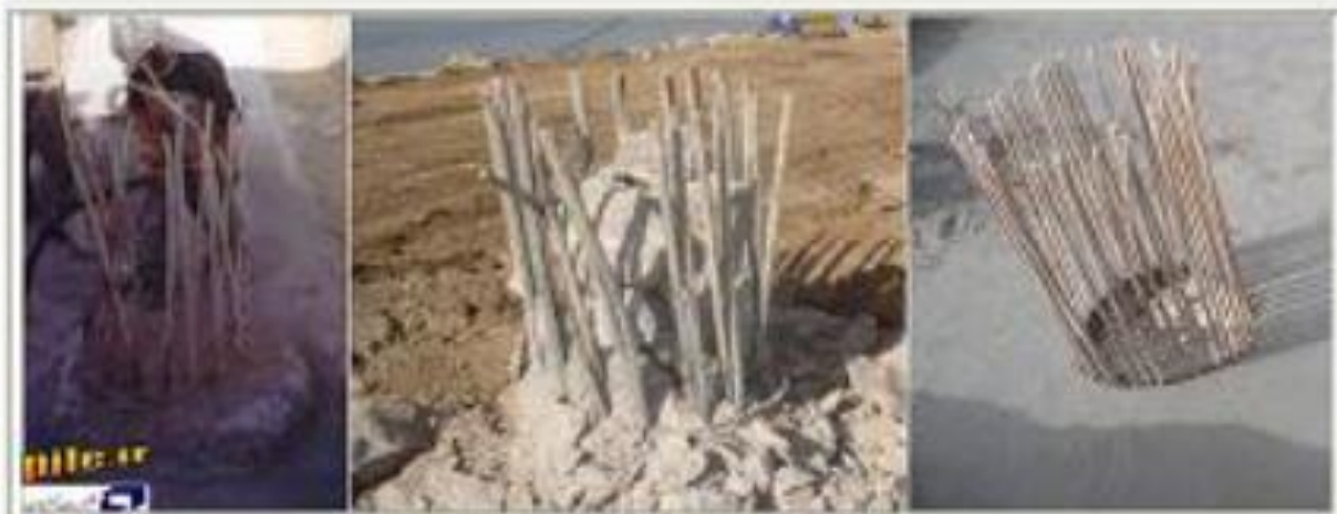
تخریب بتن گسیف روی شمع بعد از ۷ روز
