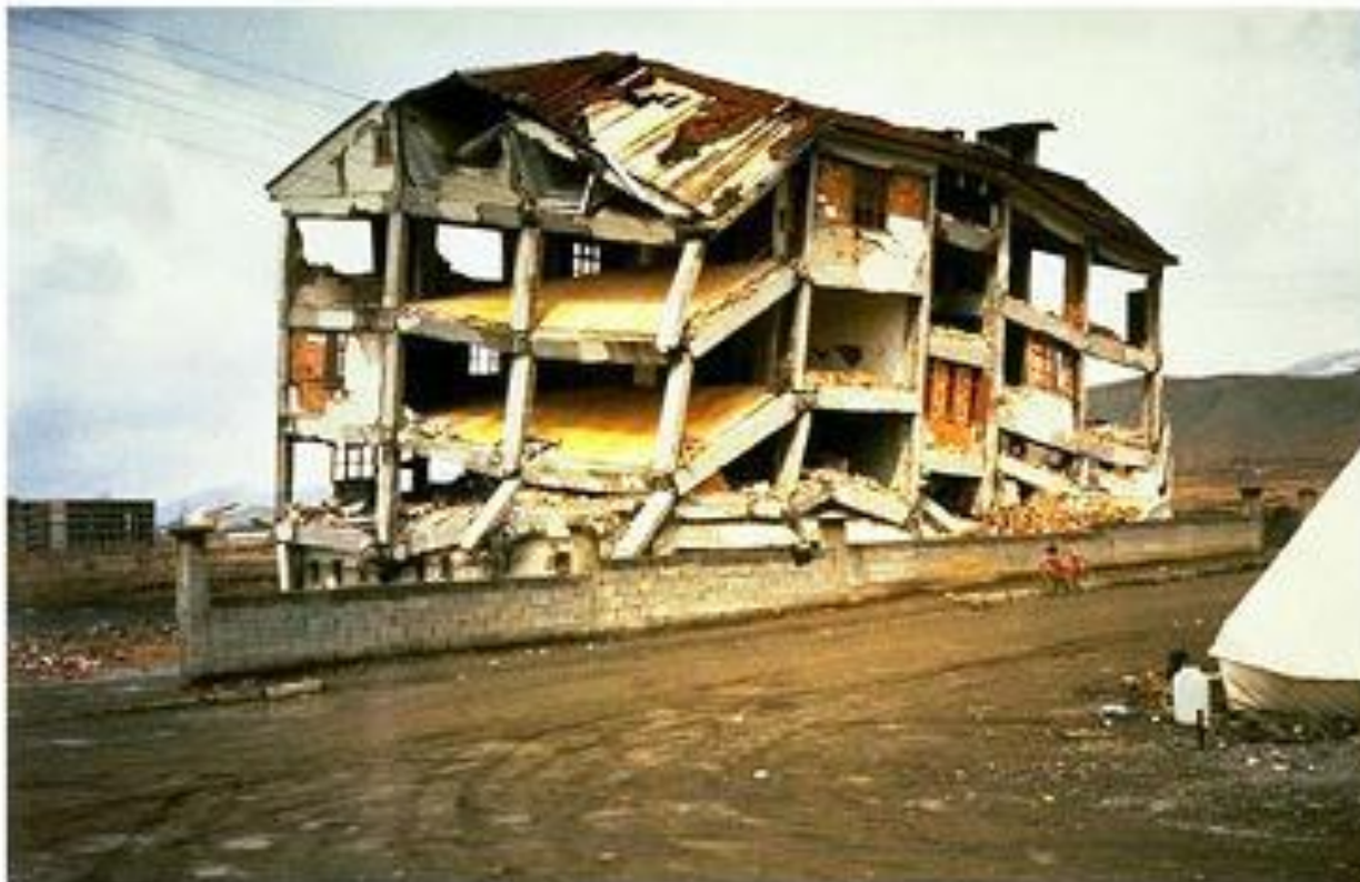
شکل ۲-۶-۱۲ تخریب اتصال در اثر کمبود میلگرد طولی که منجر به تخریب کلی سازه شده است.
